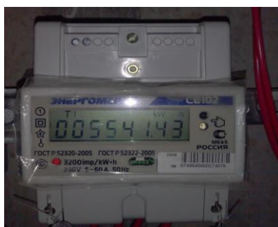
Рис. 2. Электросчётчик CE102R5 145 OK
