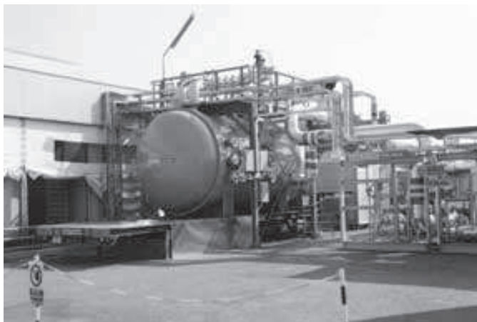
Рис. 5. Станция АФС мощностью 1 Мвт
